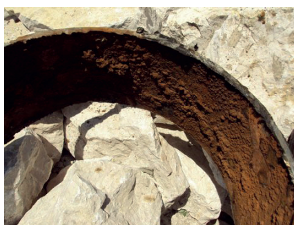
Slika 5. Korozija vodovodne cijevi
