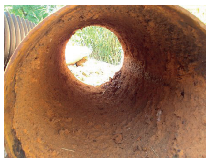
Slika 6. Nakupina kamenca u vodovodnoj cijevi
