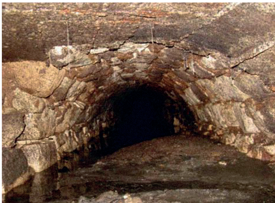
Slika 1. Srednjovjekovna kanalizacija grada Dubrovnika (izvor: Alić M. Otpadne vode kroz povijest , Hrvatska vodoprivreda 2017;218:104.)
